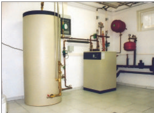
Abb. 9 Heizungskeller mit Wärmepumpe
